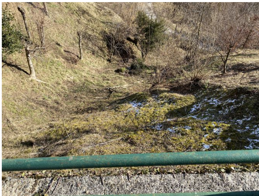
FOTO 11 - FRANA FQ3 21_9 – Anche la visione laterale di insieme non evidenzia particolare riattivazione del dissesto corticale
