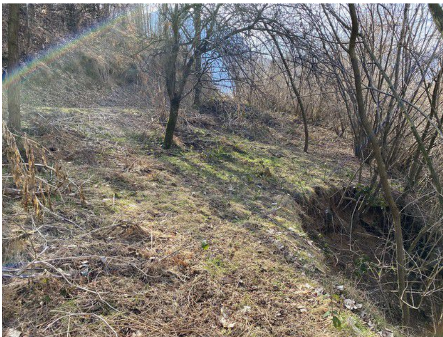
FOTO 3 - FRANA FA10 21_19 – Nicchia di frana. In secondo piano il tratto superiore del tracciato stradale
