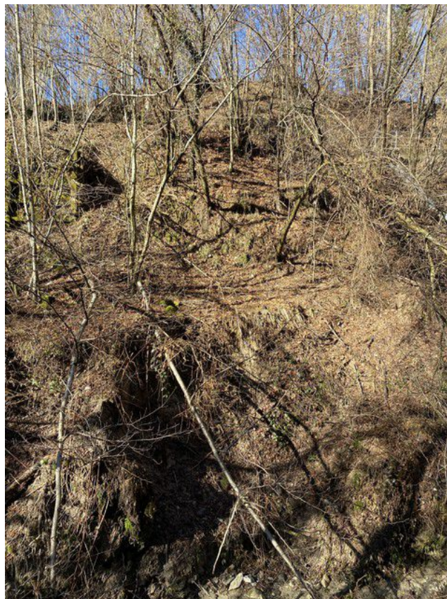
FOTO 14 - FRANA FQ3 21_11 – Segni dello scorrimento acque di dilavamento lungo il pendio, con evidenza di erosione in sponda destra corso d'acqua
