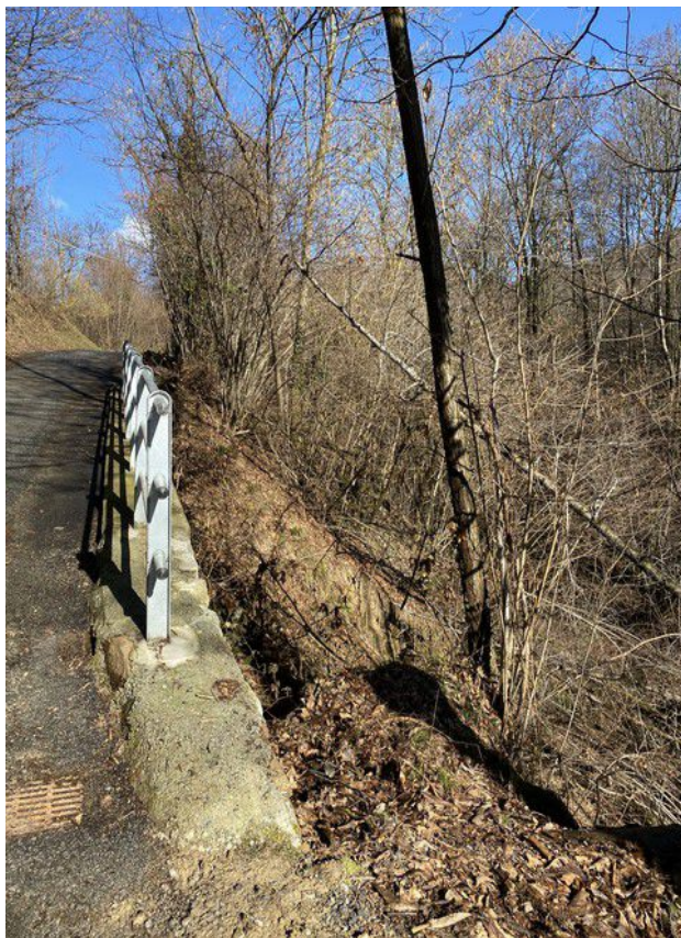
FOTO 13 - FRANA FQ3 21_11 – Panoramica del settore superiore del pendio a suo tempo interessato dalla frana al margine strada
