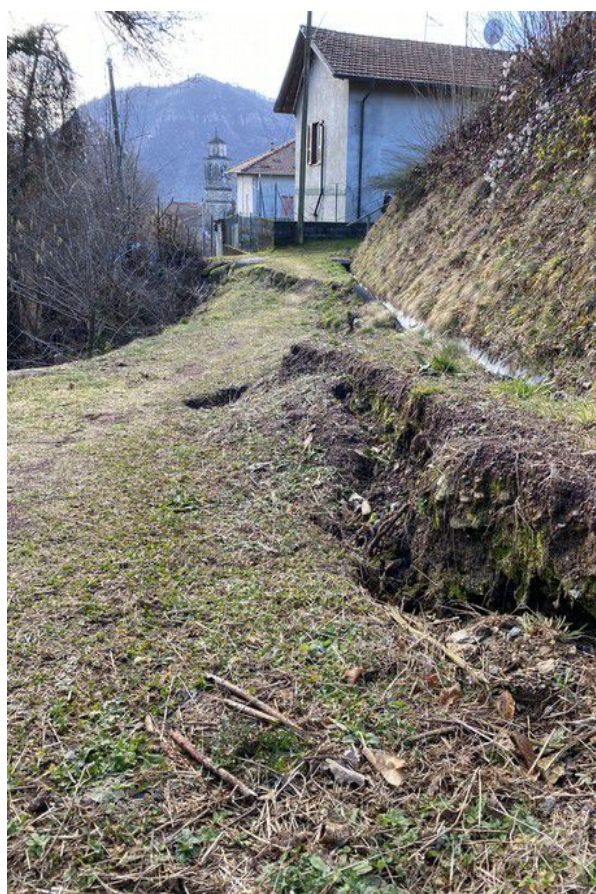
FOTO 8 - FRANA FQ10 21_15 – Particolare dal quale si evince l'entità del ribassamento
