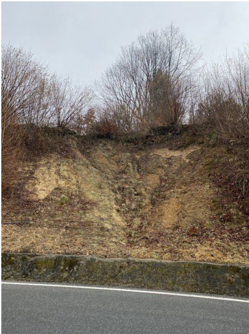
FOTO 12 - FRANA FA6 21_10 – Panoramica dell'area di frana ripresa dal piano stradale
