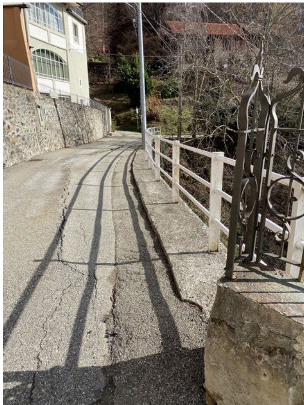
FOTO 16 - FRANA FA10 21_35 – Ribassamento del piano viabile, ma in adiacenza a trincea di scavo ripristinata
