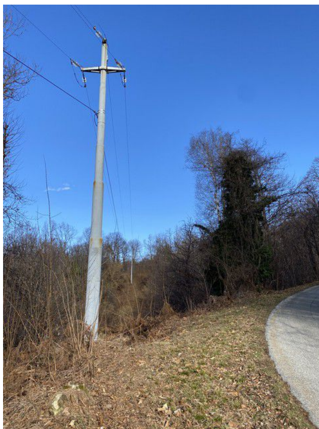
FOTO 6 - FRANA FA10 21_20 – Panoramica del sostegno della linea elettrica interessata dal ribassamento
