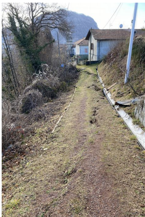
FOTO 7 - FRANA FQ10 21_15 – Aspetto del sentiero interessato dalla riattivazione della frana
