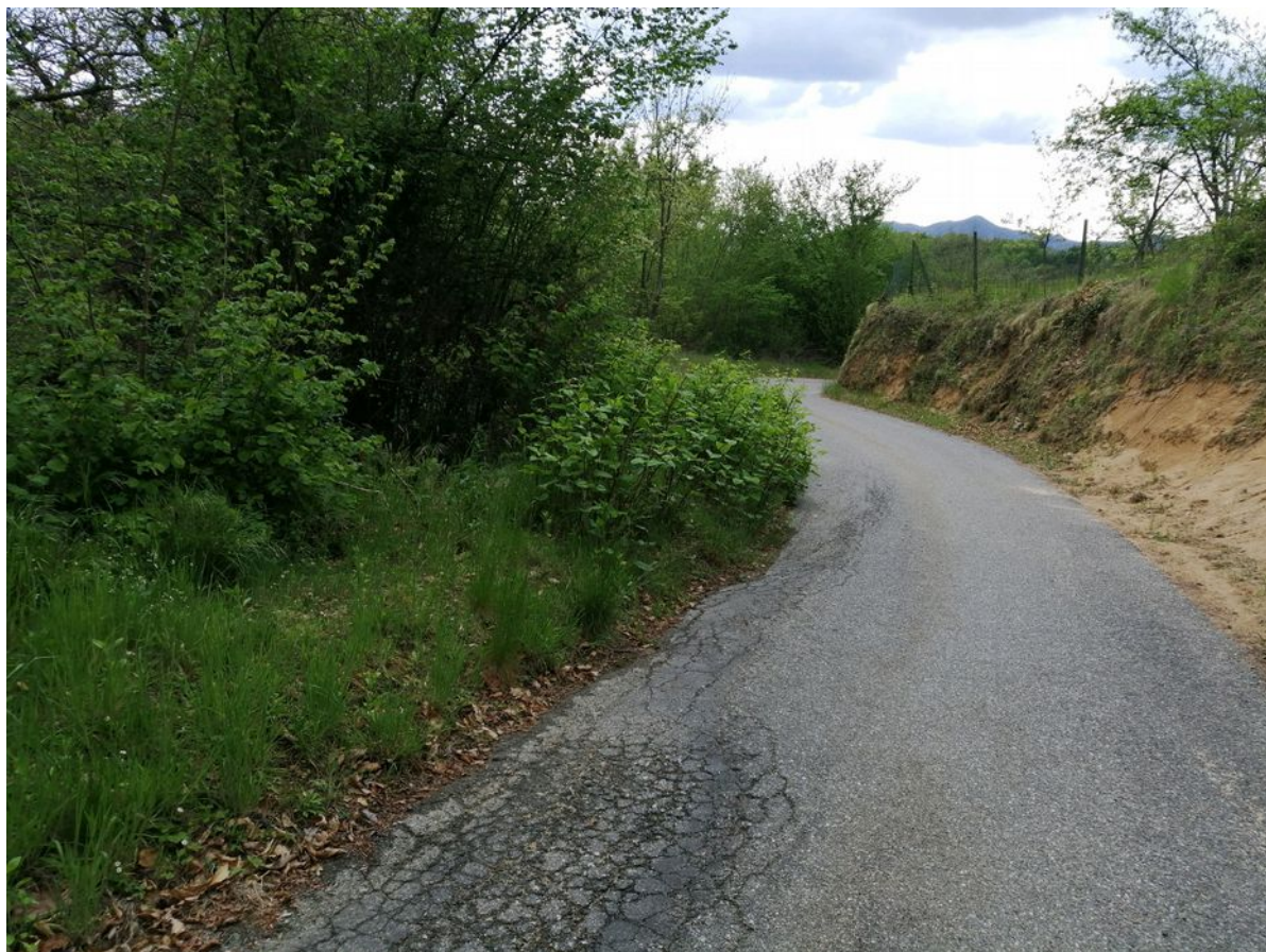
FOTO 15 - FRANA FQ6 21_76 – Panoramica del tratto stradale al coronamento del dissesto
