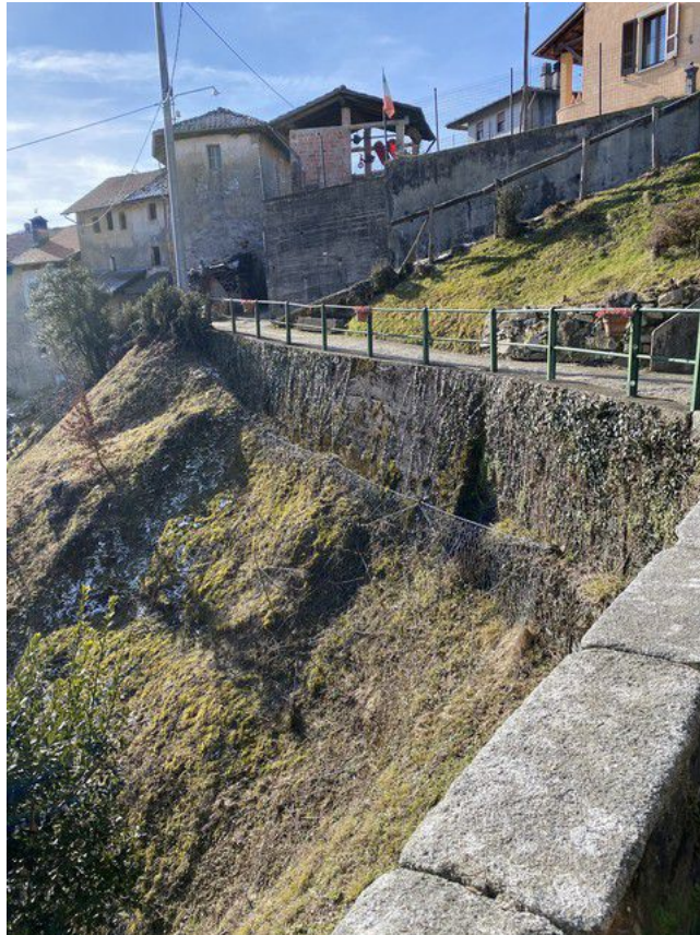
FOTO 10 - FRANA FQ3 21_9 – La visione laterale di insieme non evidenzia particolare riattivazione del dissesto corticale
